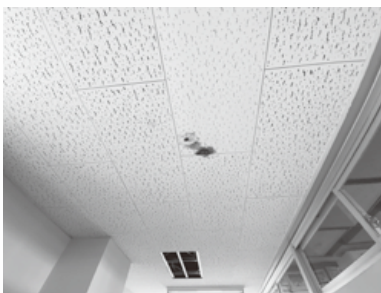
社中校舎内の雨漏り箇所
