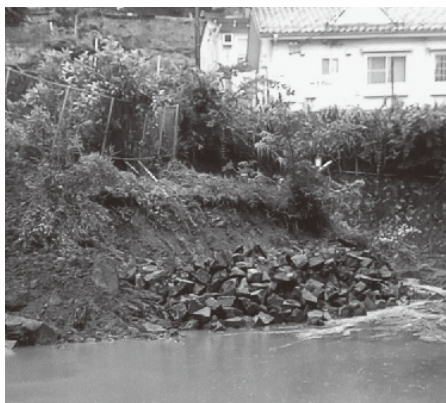
8月豪雨災害で被災した津島公園横
