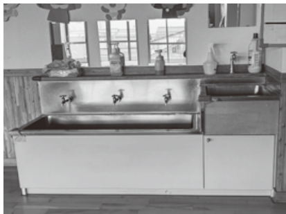
温水器が設置される予定のみずべ保育園保育室手洗い場
